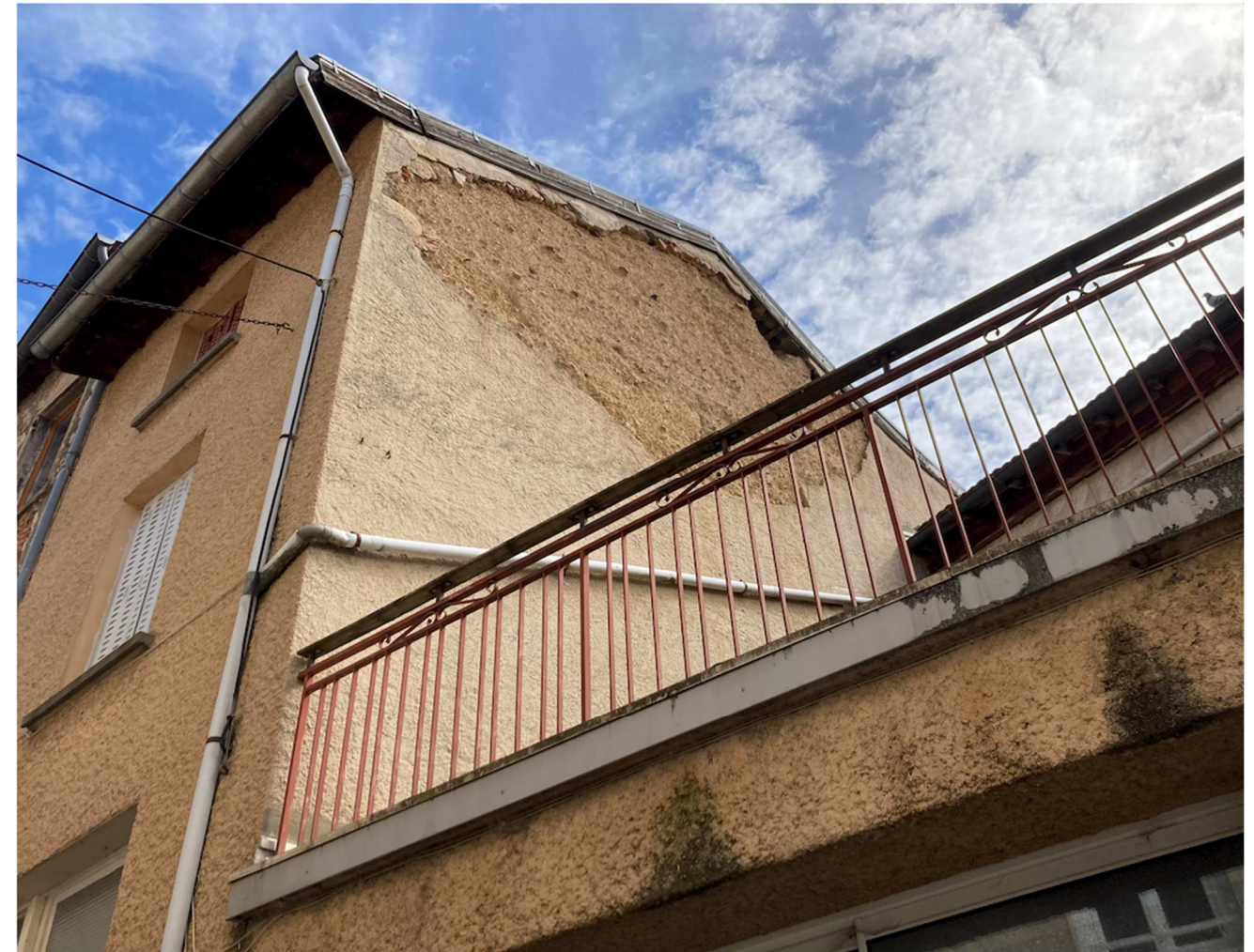
Figure 12 : Vue du pignon du tènement AN359 – fuite d'eau en toiture qui endommage le pignon (AP Management 2023)
