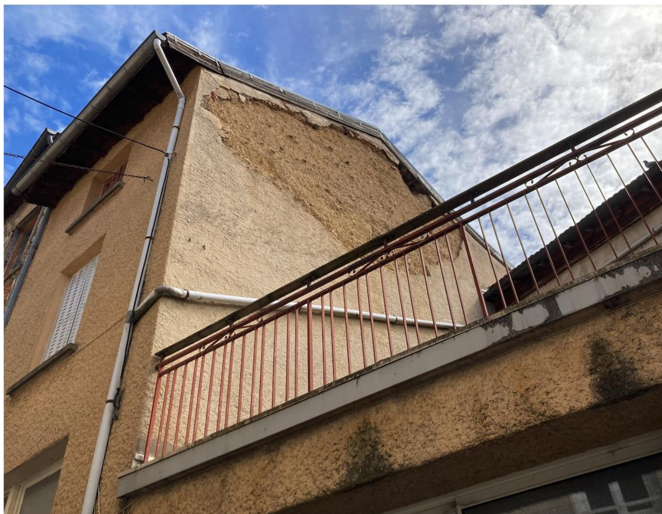
Figure 12 : Vue du pignon du tènement AN359 – fuite d'eau en toiture qui endommage le pignon (AP Management 2023)
