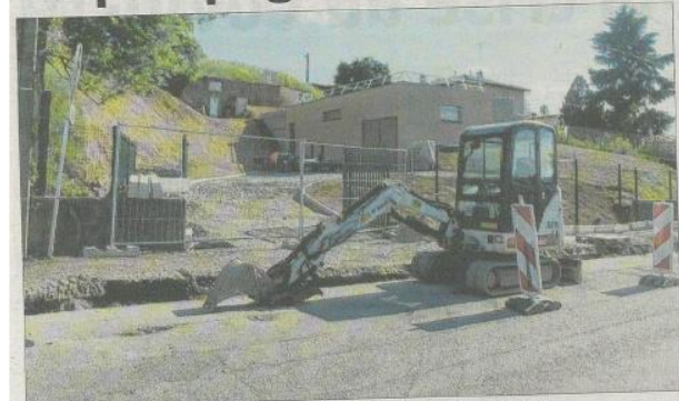
La station de pompage a mis en évidence le réservoir d'eau. Photo Progrès/Alain BLEIN
