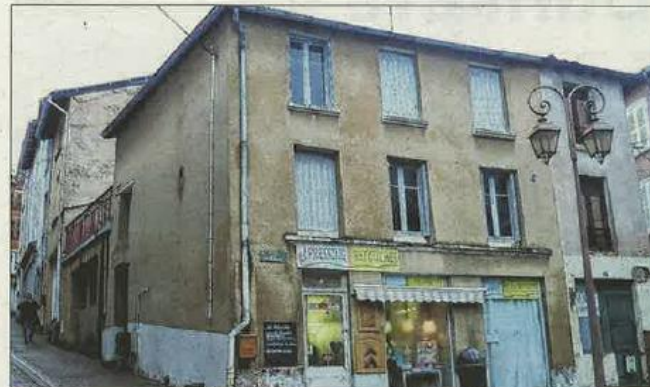
■ Le projet concerne l'îlot de maisons insalubres, situé entre la rue Étienne-Dolet et la rue Paul-Bert. Photo René BANCHET
