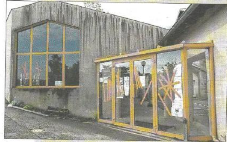
■ Les fenêtres de l'entrée et du préau de l'école publique ont été quasi toutes dégradées. L'enquête est en cours. Photo Marjorie CHEVRIER
